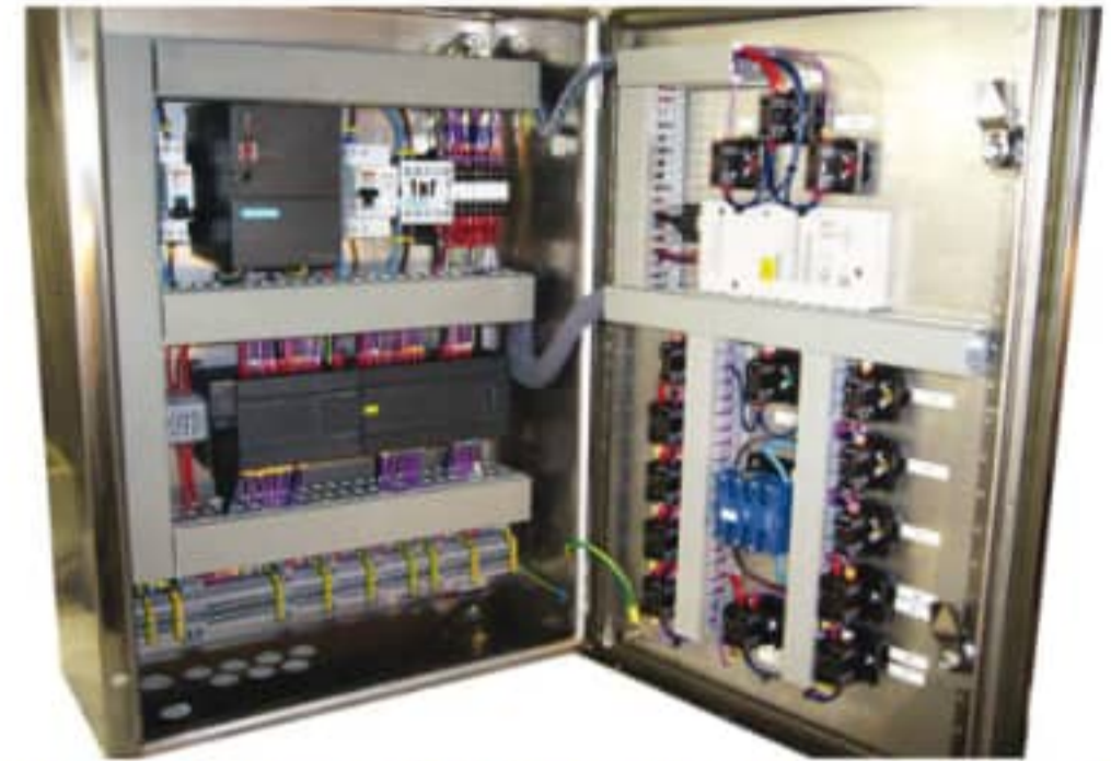
Coffret de commande d'une machine automatisé
